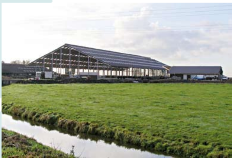
De nieuwe stal in aanbouw, met het melklokaal, voorzien van een 2x26-swing-over melkstal.
