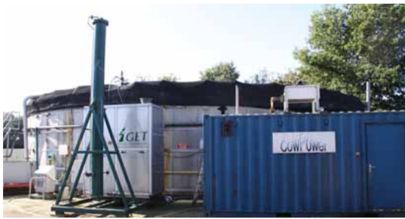
De Marke compenseert onvermijdelijke verliezen door zelf energie te produceren (Groen gas).
